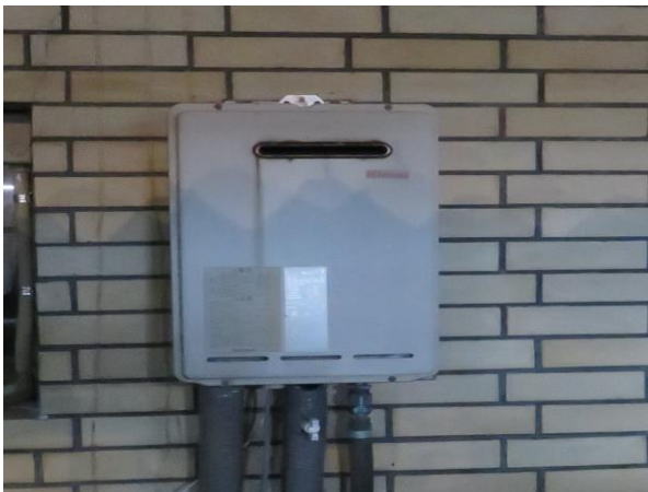
ガス給湯器1台
